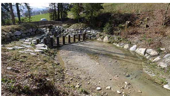
Bild 3.15 Schwemmholzrechen am Tobelausgang des Chommlibachs mit Geschiebeablagerungen. Blick flussabwärts. 22.3.2013.
