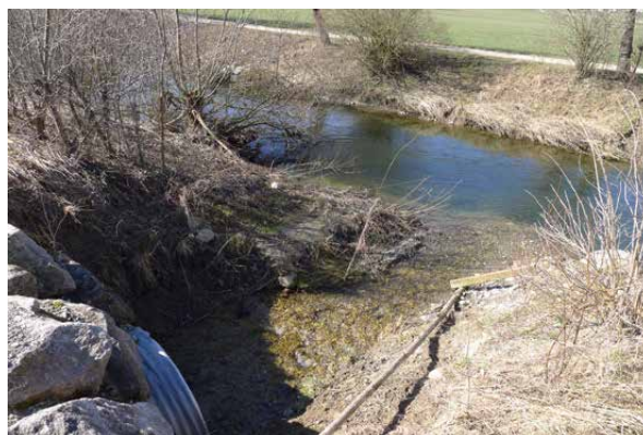
Bild 3.49 Mündung in die Suhre mit Kiesablagerungen. 22.3.2013.
