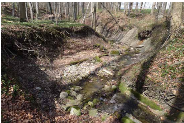
Bild 3.7 Chommlibach Oberlauf nach Waldi: Beginn Tobelstrecke mit kleiner Geschiebebank. Blick flussabwärts (17.4.2013).
