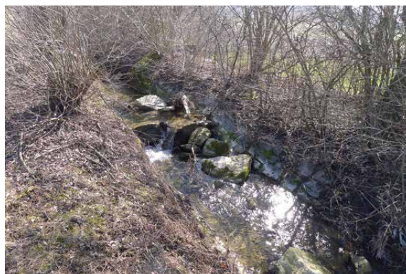
Bild 3.48 Gründelbach, Abschnitt 3, nach Anlage 2. Schwelle und Sohlenerosion. 22.3.2013.
