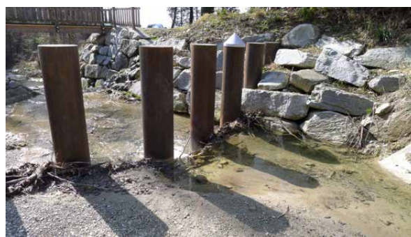
Bild 3.16 Verklausung der Zwischenräume mit Astwerk und Laub. Dahinter Geschiebe- und Feinsedimentablagerungen. 22.3.2013.
