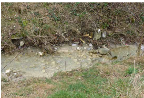
Bild 5-22 Sohlenerosion flussabwärts Moosstrasse.
