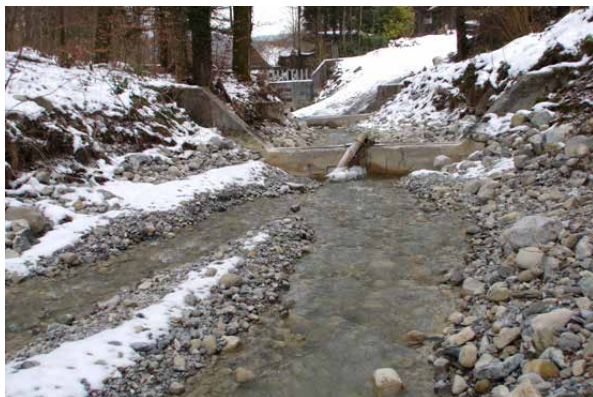
Bild 5-16 Geschiebesammler Vorderbach mit den zwei ausgebagerten Vorsperren mit Öffnungen. Im Hintergrund ist die Sperre des Sammlers zu sehen (21.2.2013).
