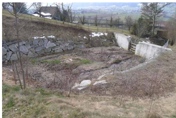
Bild 4-13 Geschiebesammler mit Schlitzsperre und bewachsenen Ablagerungen im Rückhaltebereich. 6.3.2013.
