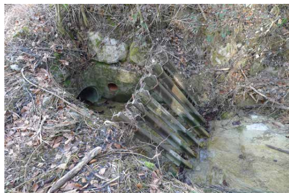
Bild 4-29 Rechen vor Durchlass (6.3.2013).
