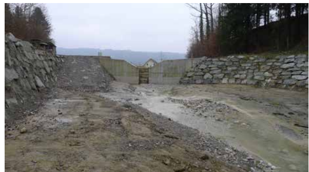
Bild 5-6 Blick vom Oberwasser zur Sperre (6.3.2013).
