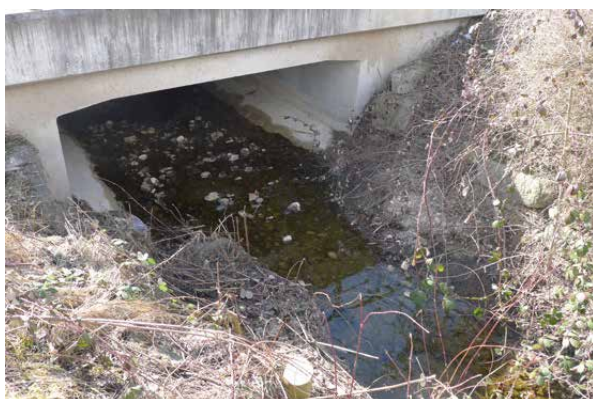
Bild 3-30 Leichte Sohlenanhebung beim Einlauf des SBB-Durchlasses (6.3.2013).
