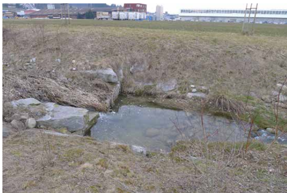
Bild 2-3 Schwelle mit tiefem Kolk (6.3.2013).
