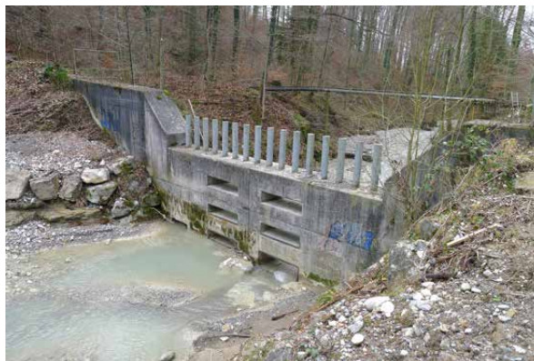
Bild 5-17 Geschiebesammler Vorderbach: Rostsperre mit aufgesetztem Grobrechen, Blick in Fließrichtung (7.1.2013).
