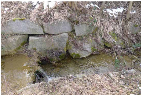
Bild 4-9 Abschnitt 2 flussabwärts Geschiebesammler. Starke Einengung mit ausgeprägtem Geschiebedefizit (6.3.2013).
