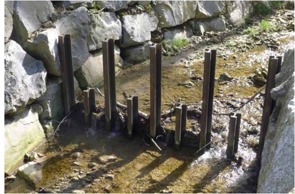
Bild 3-8 Räckholdernbach: Teilverklauster Rechen, Blick gegen Fließrichtung (17.4.2013).
