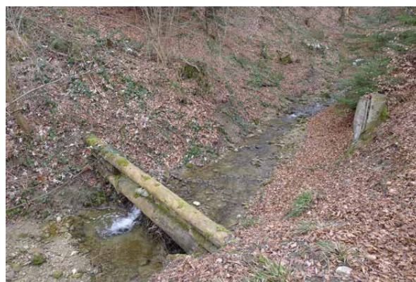
Bild 2-7 Tobelstrecke Birgenbach mit unterspülter Rundholzschwelle. 6.3.2013.
