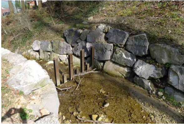
Bild 3-7 Räckholdernbach. Schwemmholz- und Geschiebesammler mit Rechen. Blick in Fließrichtung (17.4.2013).
