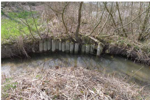
Bild 3-9 Räckholdernbach: Abgetiefte Sohle im Mündungsbereich. Uferverbau mit Betonrohren im Naturschutzgebiet. Fließrichtung von links nach rechts (17.4.2013).
