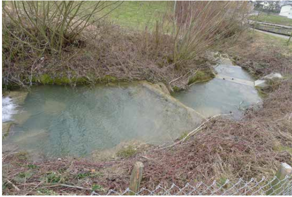
Bild 4-3 Verbaute Steilstrecke unterhalb Anlage 2 mit ausgeräumten Schwellenfeldern (6.3.2013).
