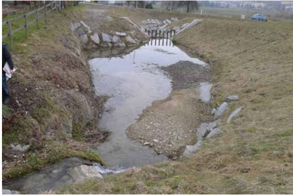
Bild 2-11 Ablagerungen im Zulaufbereich: Vorwiegend Sand und Schluff, wenig Kies. 6.3.2013.
