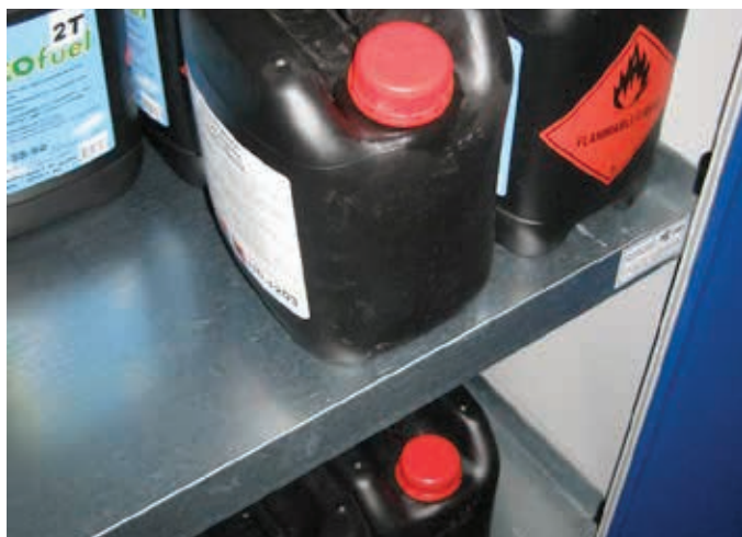
Entzündbare Flüssigkeiten müssen in einem nicht brennbaren Schrank mit Auffangwanne gelagert werden,...
