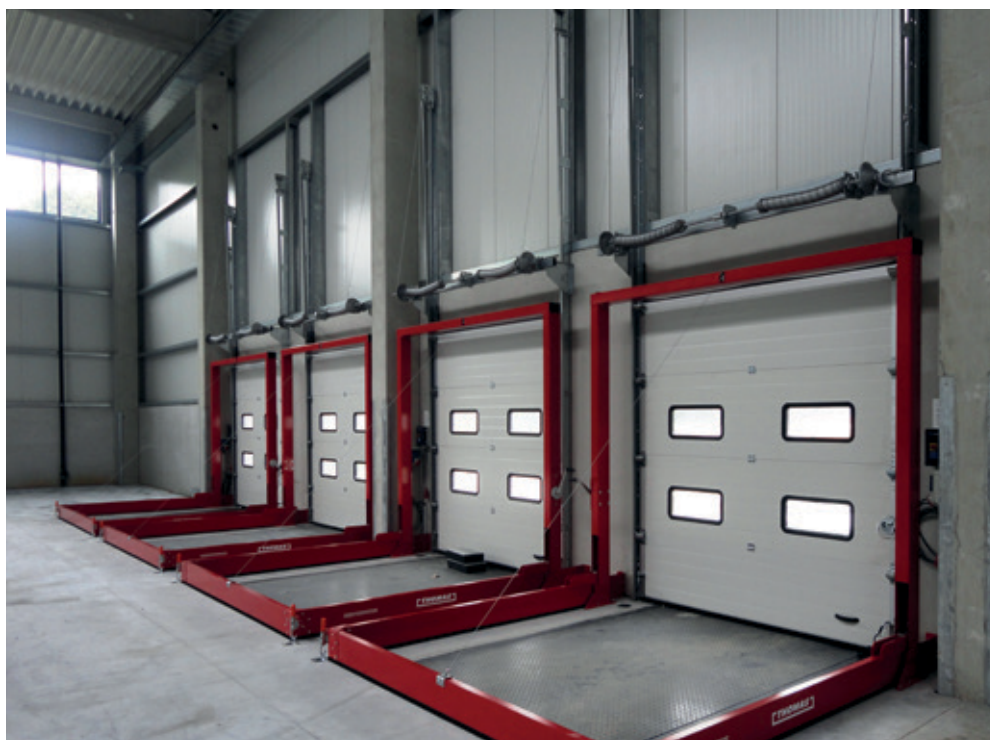
Manuelle Löschwasserbarrieren bei Laderampen
