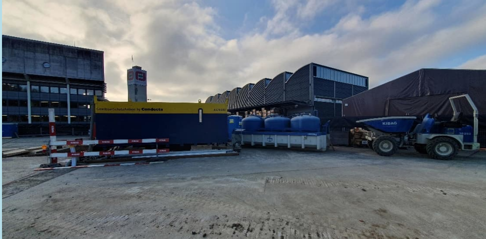
Abbildung 2: Bild einer aufwändigen Vor- behandlungsanlage des Bastellenabwassers auf einem mit PFAS belasteten Standort im Surental.
