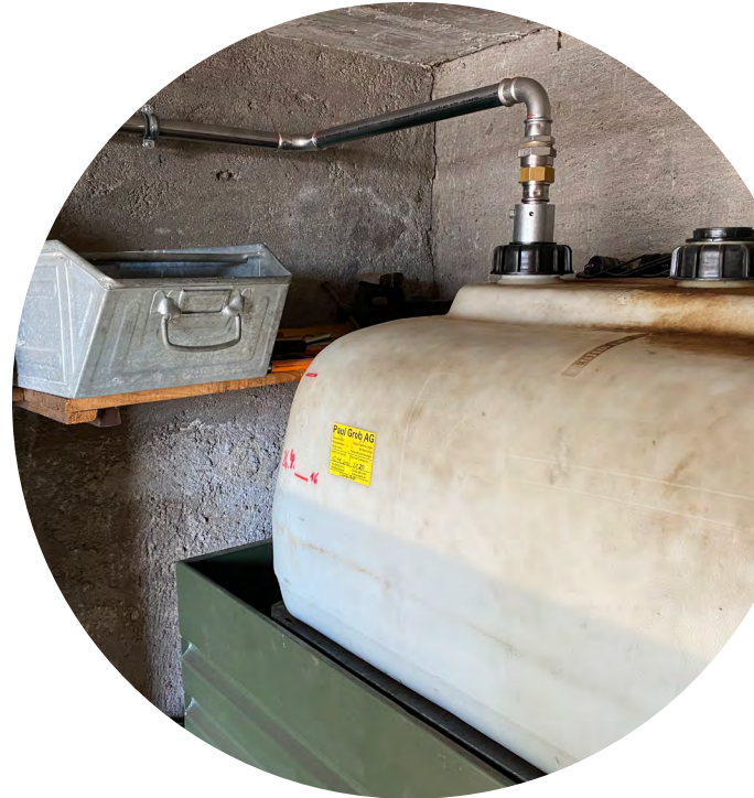
Oberirdischer Sammelbehälter mit Rückhaltewanne
